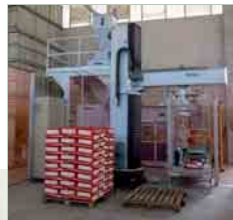
Il WINtech installato presso Sementi Continental, Traversetolo - Parma WINtech installed at Sementi Continental, Traversetolo - Parma Installation WINtech a Sementi Continental, Traversetolo, Parme El modelo WINtech instalado en la empresa Sementi Continental (Traversetolo, Parma).
